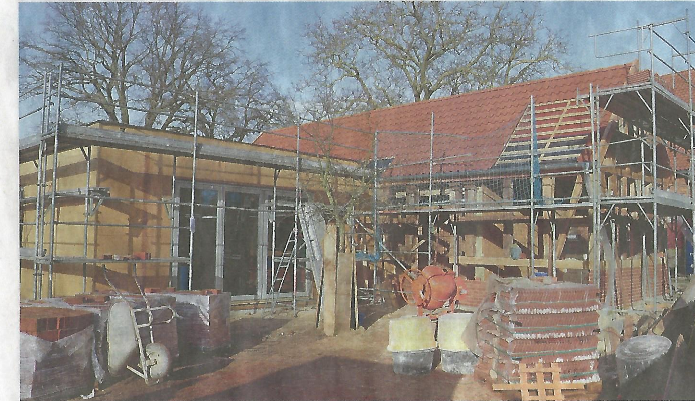
Für 330 000 Euro lässt die Gemeinde Damnatz sich einen Mehrzweckraum, eine Art Dorfgemeinschaftshaus, errichten. Finanziert wird das Ganze größtenteils über Fördertöpfe – und aus der gut gefüllten Rücklage der Elbkommune. Aufn.: R. Groß
