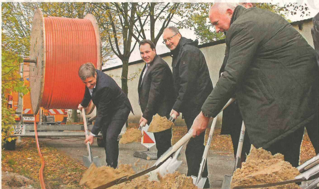
Symbolisch legten am Dienstag gleich eine ganze Reihe von Lüchow-Dannenberg Verwaltungsspitzen Hand an beim Auftakt zu den Glasfasernetz-Tiefbauarbeiten. Neben (von rechts) Landrat Jürgen Schulz griffen auch Elbtalauers Samtgemeindebürgermeister Jürgen Meyer und Gartows Samtgemeindebürgermeister Christian Järnecke zum Spaten. Aufn.: R. Groß
